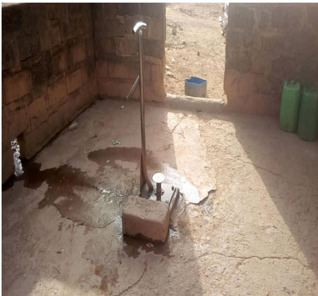
PHOTO N°5 : la fontaine du quartier Médine
